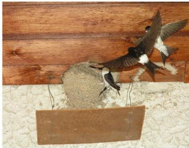
Fot. 8 Oknówki przy gnieździe. Przed pobrudzeniem ściany odchodami chroni półeczka pod gniazdem (A.Benko, www.wikipedia.org )
