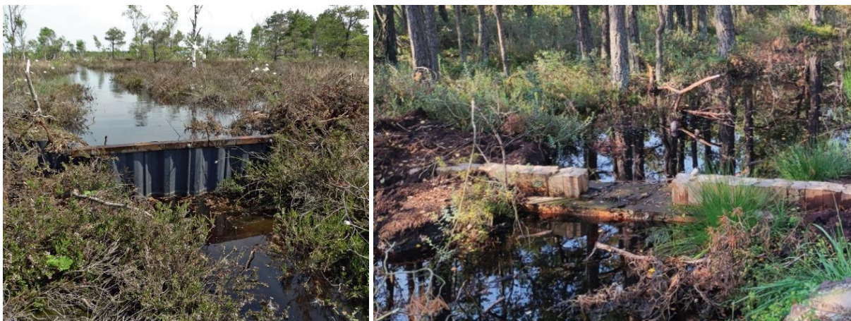
Przegrody na rowach melioracyjnych wykonane z plastiku (po lewej) i drewna (po prawej). Fot. Paweł Pawlaczyc
